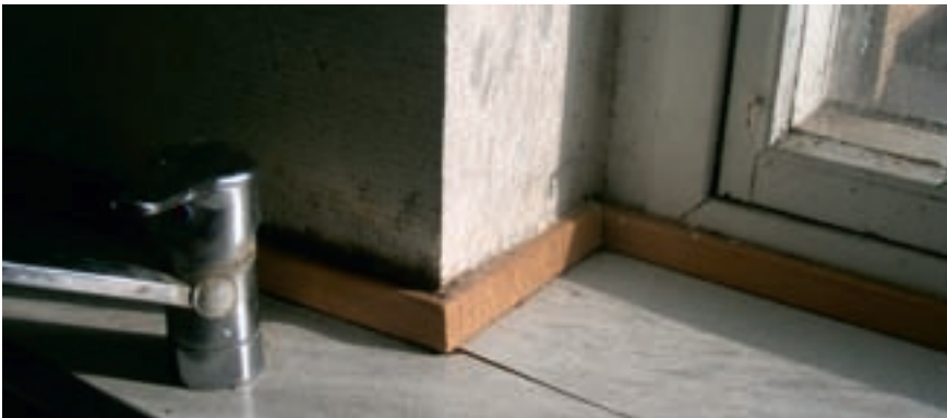
Fugt og skimmelsvampevækst i et køkken
