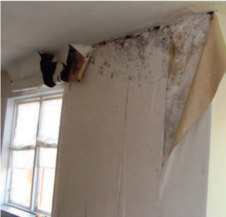
Omfattende fugtskade og skimmelsvampevækst
