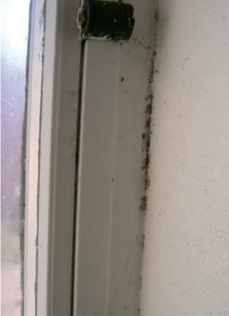
Kuldebro med fugt og skimmelvækst
