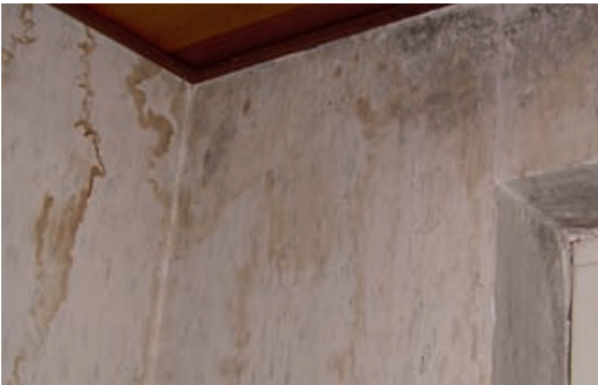
Omfattende fugtskader og skimmelsvampevækst
