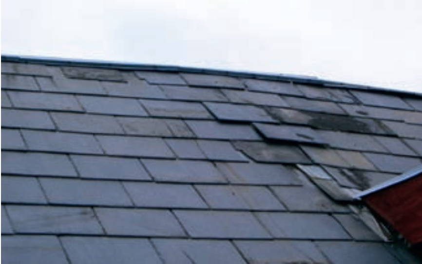
Manglende vedligeholdelse med vandindtrængen
